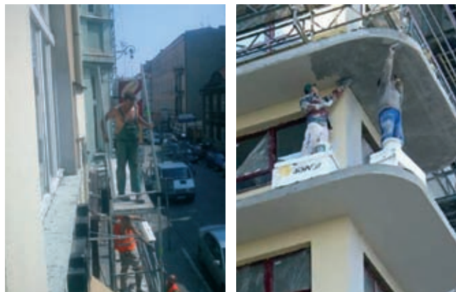
Rys. 3. Przykłady nieodpowiedzialnego zachowania przy eksploatacji i montażu rusztowania
