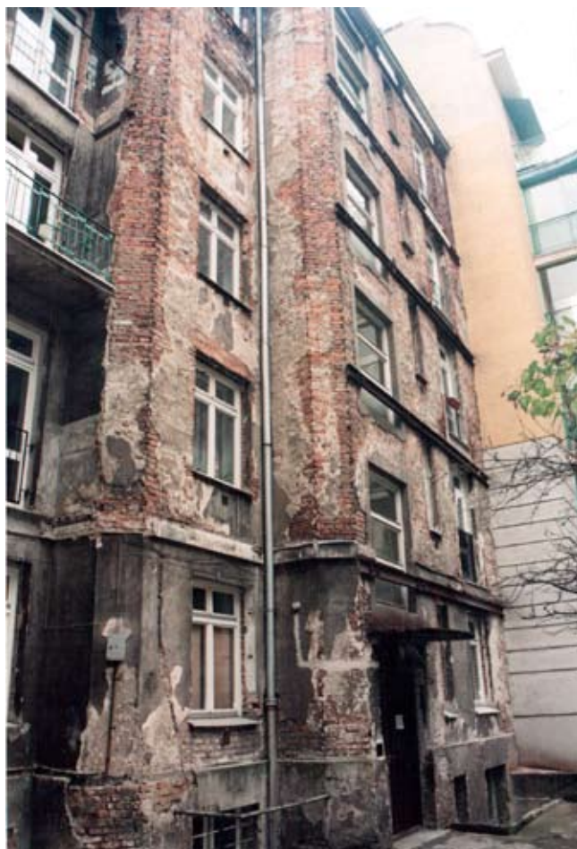
Rys. 2. Ocena i wzmocnienie budynku murowego
