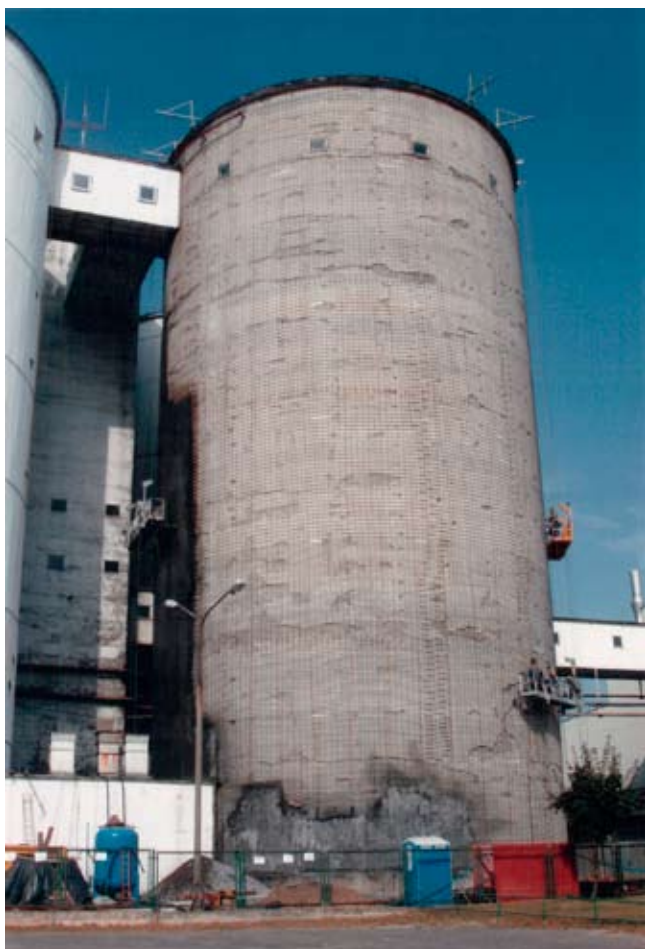
Rys. 1. Ocena wzmocnienia silosu żelbetowego na cement
