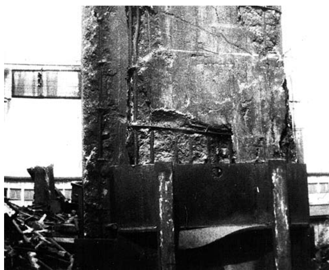
Rys. 9. Korozja zbrojenia słupa żelbetowego
