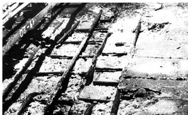
Rys. 10. Korozja zbrojenia płyty żelbetowej w zakładach chemicznych
