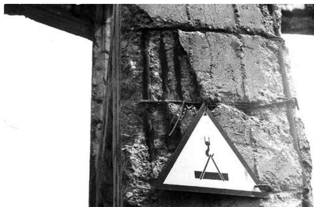
Rys. 8. Korozja zbrojenia słupa żelbetowej estakady
