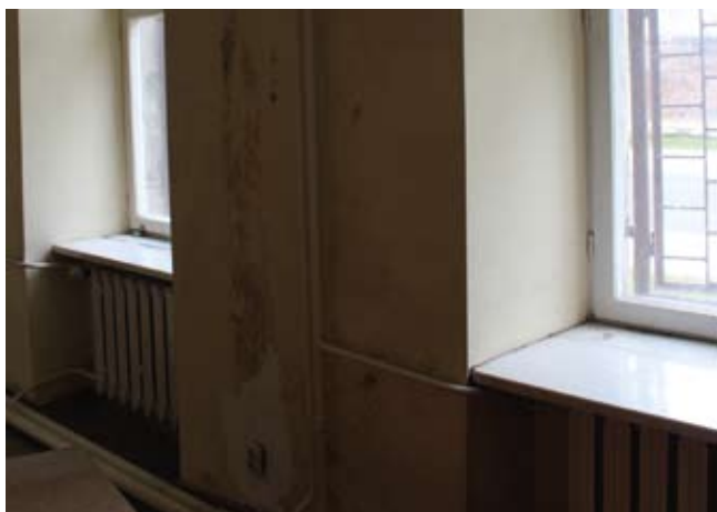
Przykład braku właściwej izolacji fundamentów
