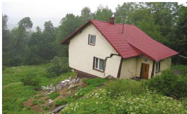
Rys. 9. Zniszczenia spowodowane osuwiskiem podłoża (źródło: internet)
