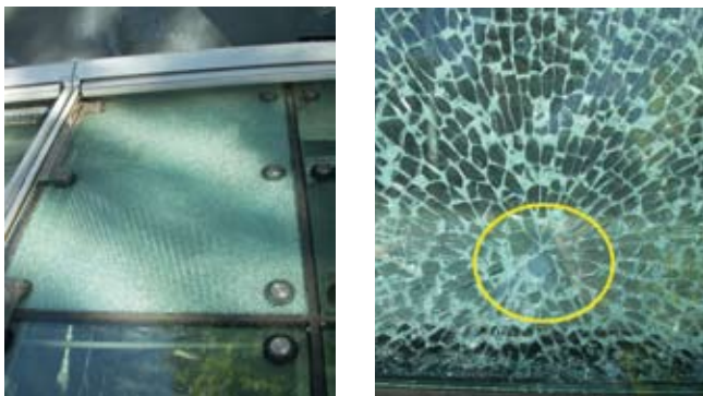
Rys. 3. Uszkodzenie tafli szklanej zadaszenia budynku, spowodowane zmianą objętości inkluzji siarczku niklu
