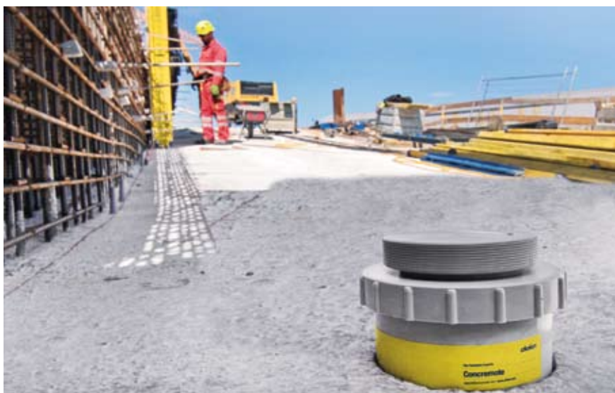
Czujnik Concremate zabetonowany w stropie
