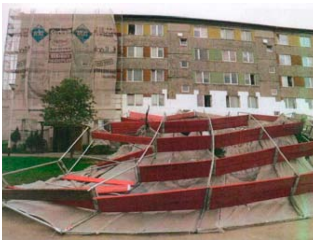
Rys. 6. Katastrofa budowlana rusztowania fasadowego, w którym nie uwzględniono wpływu plandeki na wymaganą nośność kotew (fot. z archiwum PIP) [14].
