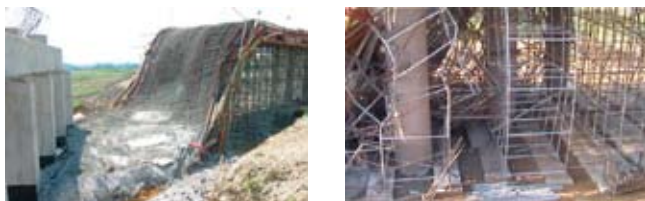
Rys. 5. Katastrofa budowlana systemu podparcia w Ogrodzonej (fot. z archiwum PIP) [14]
