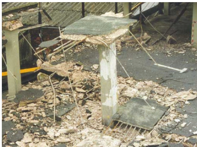
Rys. 1. Częściowe zawalenie się Pipers Row Car Park (parkingu) w Wolverhamton, 1997 r. [1]
