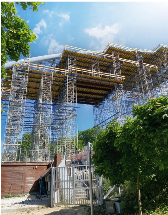
Stabilność i precyzję podczas całego procesu budowy zapewniła stalowa rurowa konstrukcja łukowa, wykorzystując system platform zbudowany z wież podporowych Staxo 100 i elementów rusztowania Ringlock
